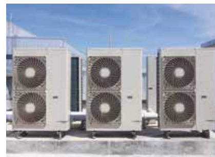
Ventilationssystemer og varmepumper
